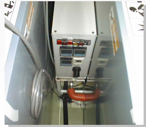
ポンプ間の狭い空間に熱交換器制御部 一体で設置
